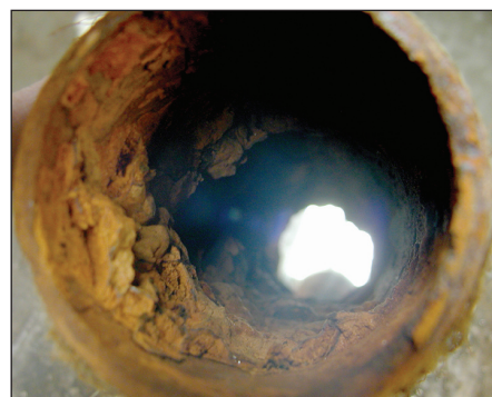
Käyttövesiputki ennen Baueria.
